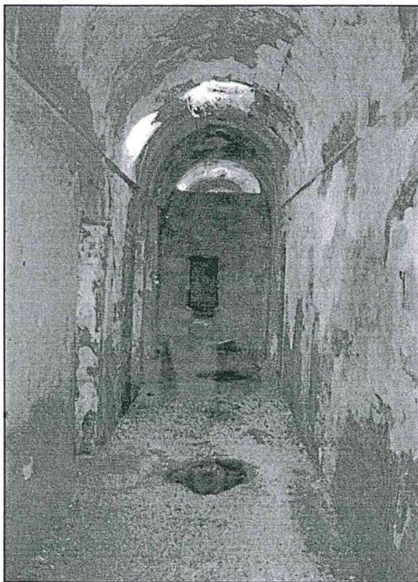
La fatiscenza di un corridoio prima del restauro
